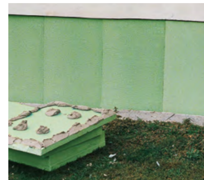
Fig. 28: Risanamento di una vecchia costruzione; incollaggio di lastre di Styrodur® 2800 C con procedura di giunzione a punti sul bordo.
