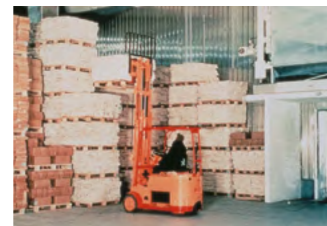
Fig. 14: I carrelli elevatori, le merci stoccate e le scaffalature producono sollecitazioni a carico dei pavimenti del deposito frigorifero isolato termicamente.
