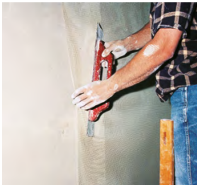
Fig. 30: Posa su tutta la superficie della rete di armatura in fibra di vetro. I teli di rete sono sovrapposti di circa 100 mm.
