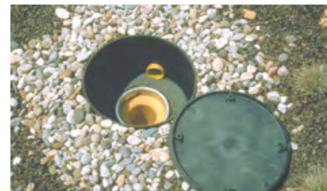
Fig. 10: Bocchetta di scarico del tetto.
