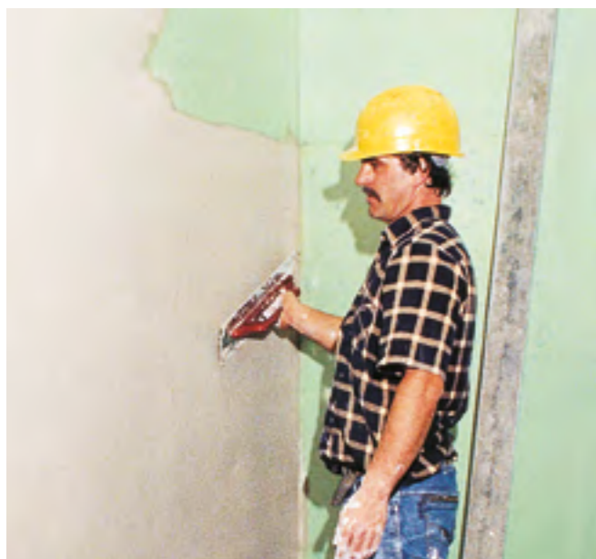
Fig. 29: Stesura del primo strato di intonaco adesivo a base di gesso; spessore dell'applicazione 10 mm.
