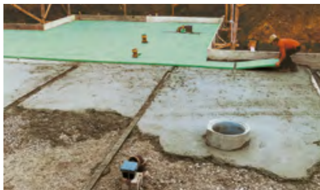
Fig. 6: Strato di protezione in calcestruzzo magro per la posa dell'isolamento del pavimento.
