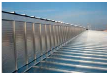
RACCORDO SU EDIFICIO A DIVERSI LIVELLI CONNECTION WITH A DIFFERENT LEVEL BUILDING
